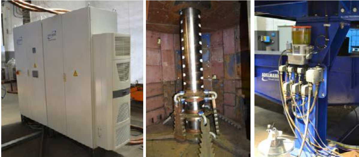
Abb.: Schaltschrank mit FU, AVB Schlagraum und automatische Fettschmieranlage
